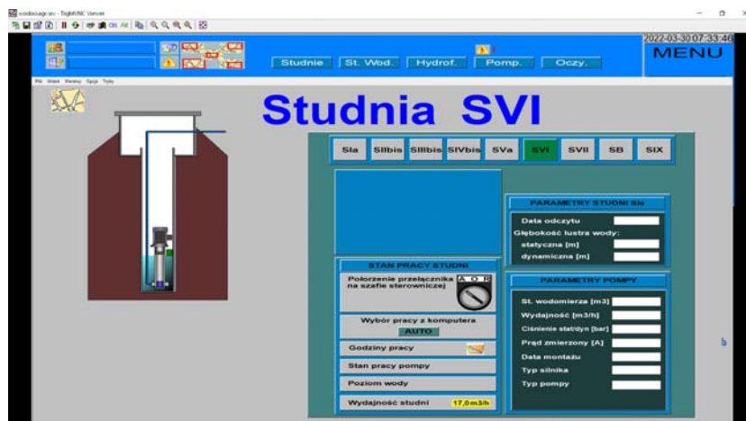
Studnia głębinowa wraz z wizualizacją w systemie
